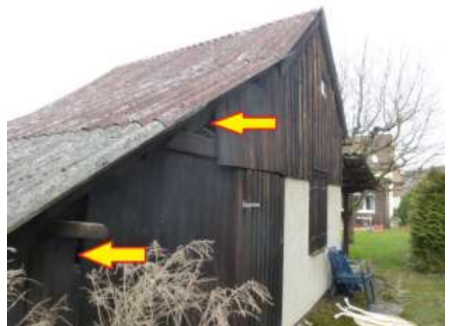
Abb. 7: Östliche Wand mit Schuppen mit Zugangsmöglichkeit für Marder.
