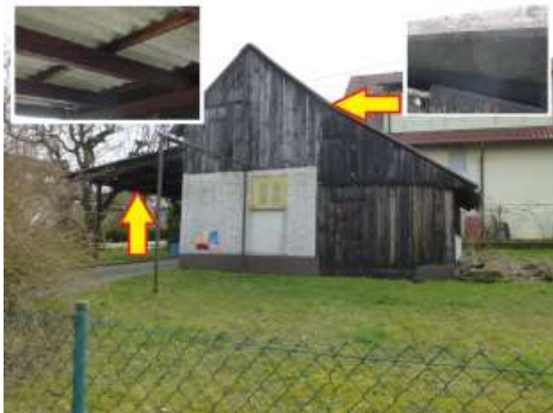
Abb. 6: Schuppen auf Flst.-Nr. 2996 mit Vorbau und Abstand zwischen Dach und Wänden.
